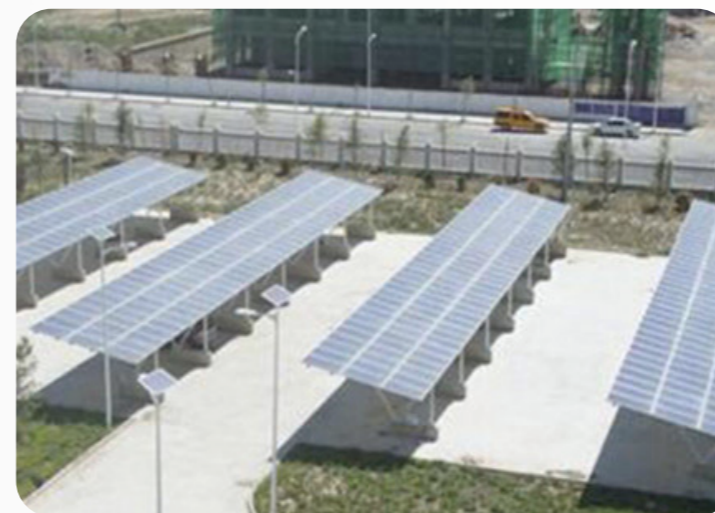
ドバイ カーポート200KWプロジェクト ▲
