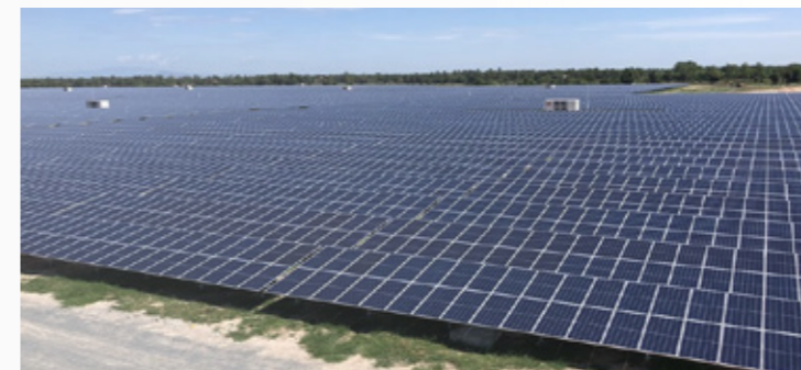
カンボジア100MW太陽光発電所 ▲
