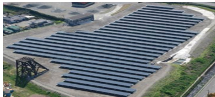
▲ 日本福岡6MW太陽光発電所
